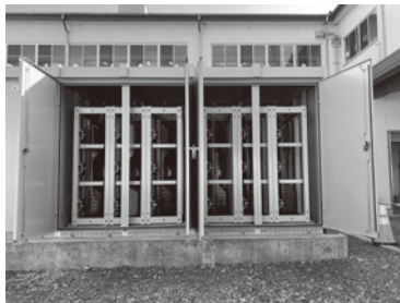
《蓄電池バック》
