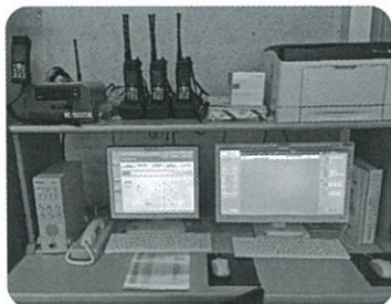
役場2階(基地局設備)
