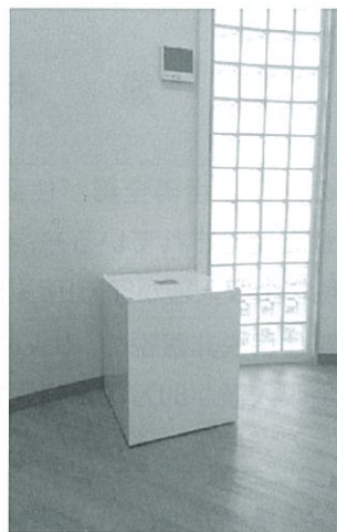
保育所内蓄電池
